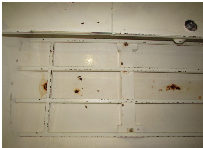
Puntos de corrosión reparables en la sentina
