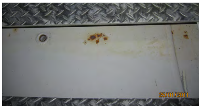
Puntos de corrosión reparables en la sentina
